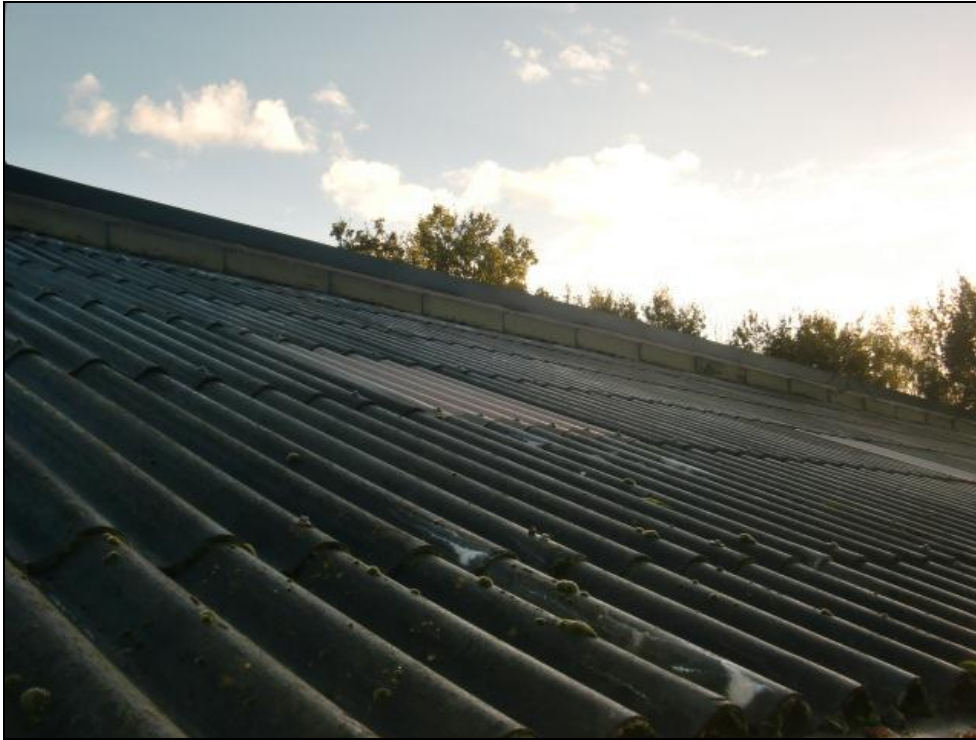
Foto 1, Koeienstal, dak; AC golfplaten type 1 Monster AMP001
