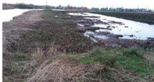
Figuur 5.6 Pas gegraven petgat met flauwe taluds in het Wormer- en Jisperveld. <foto: Ecogroen, 2015 / H. Brendeke>
