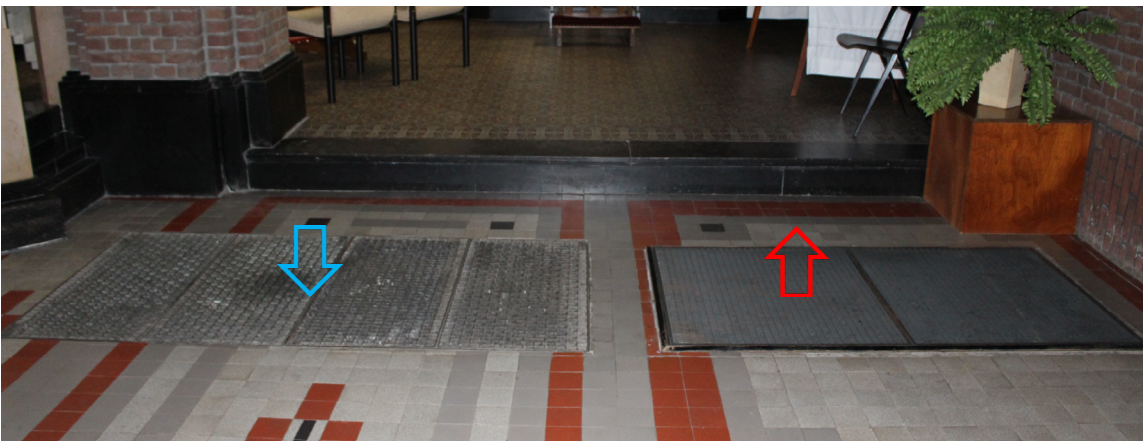
Inblaas- en retourkanaal in de vloer van de Heilige Jacobuskerk in Cabauw. Omdat de roosters dicht bij elkaar in een zijbeuk zijn gesitueerd, ontstaat snel 'kortsluiting' en is de warmteverdeling in de kerk niet optimaal.
