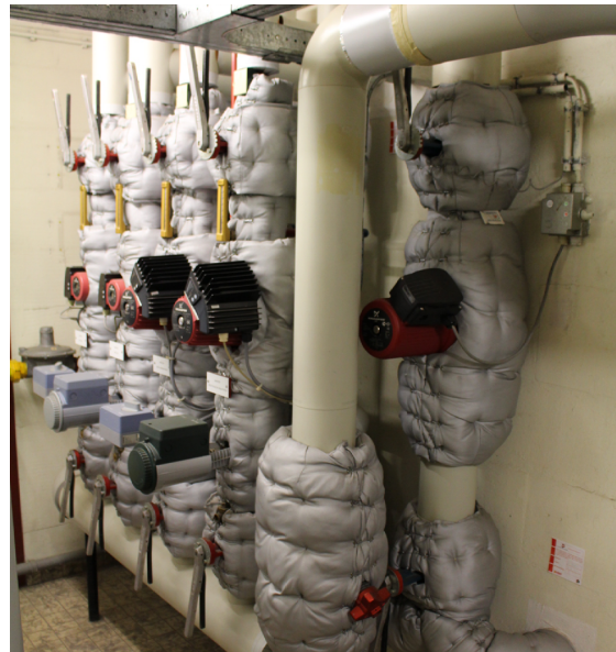
Leidingsisolatie en het aanbrengen van isolerende mantels bij kranen en koppelingen voorkomt veel onnodig warmteverlies.
