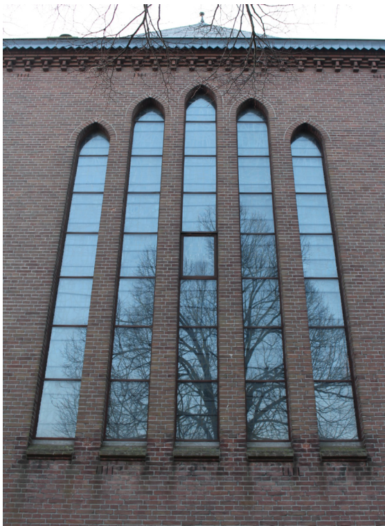
Beschermende buiten-voorzetsbeglazing bij een groot samengesteld kerkraam van de St. Willibrorduskerk in Vleuten.
