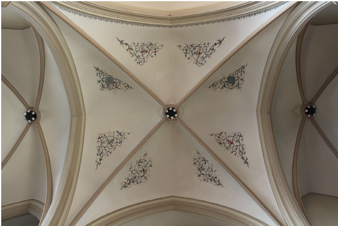
Gewelven in de H.H. Cosmas en Damianus kerk in Abcoude. Complexe gewelfvormen zijn lastig te isoleren. In de meeste gevallen is het af te raden.
